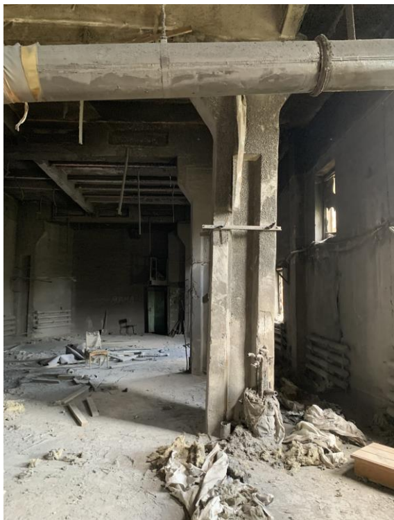
Рисунок 5. Отклонение колонны от вертикальной оси Figure 5. Column deviation from the vertical axis
