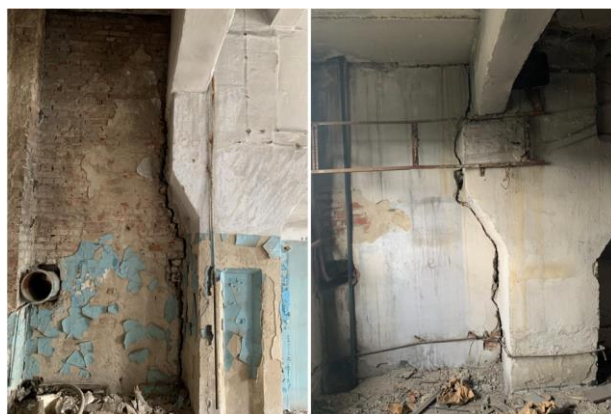
Рисунок 7. Трещины между внутренними стенами и колоннами Figure 7. Cracks between interior walls and columns
