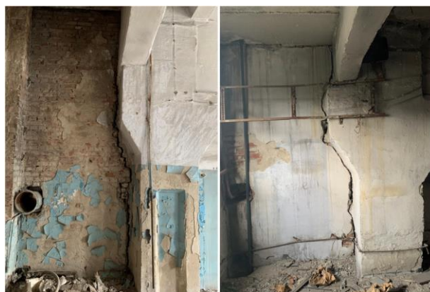
Рисунок 7. Трещины между внутренними стенами и колоннами Figure 7. Cracks between interior walls and columns
