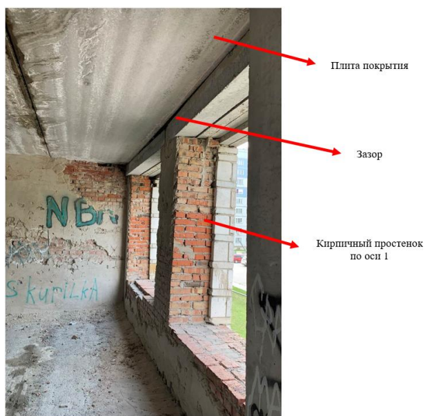
Рисунок 3. Отклонение кирпичного простенка от вертикали на 50 мм на 2-ом этаже (ось 1/А-В)
